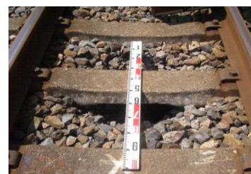
写真-2 路盤陥没の発生状況
