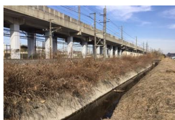
写真-1 路盤陥没多発区間の全景
