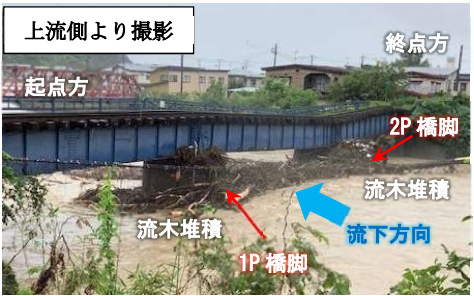
図-1 橋りょう被災状況
