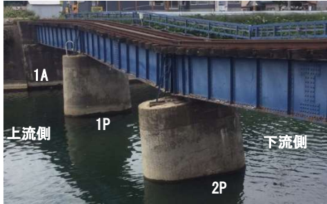
図-2 2P橋脚被災後全景（流木等除去後）
