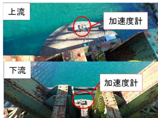
図3 P4 センサ設置状況
