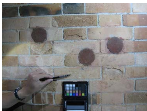
写真-3 RHT試験後の打撃面（通常の煉瓦）
