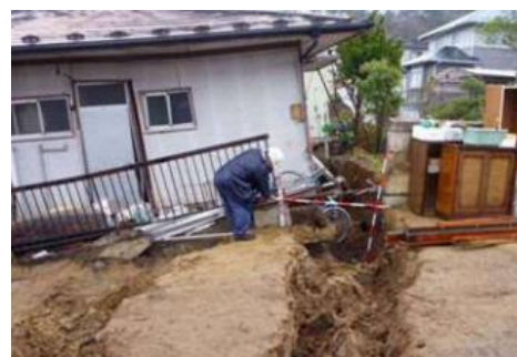
図-1 宅地地盤のクラック 1)
