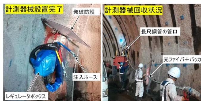
図-5 計測器械の設置、回収状況
