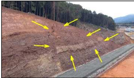
図-1 法面のクラック発生状況
