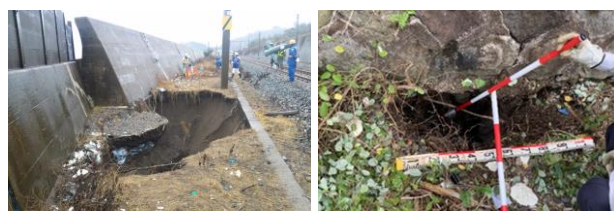
図1 大規模陥没（左）と小規模陥没（右）
