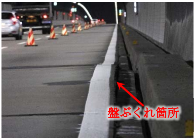
写真-1 盤ぶくれ発生状況
