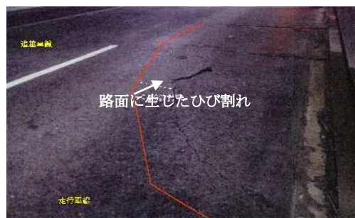
写真1 路面におけるひび割れ状況
