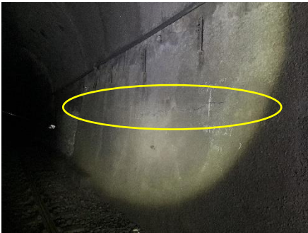
写真 1 ひび割れ状況
