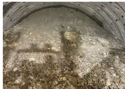
写真-1 TD.319m の天端崩落
