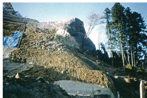
図-2 露頭した硬質な安山岩(建設時)
