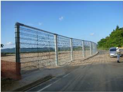
写真-2 自立式フェンス防護柵
