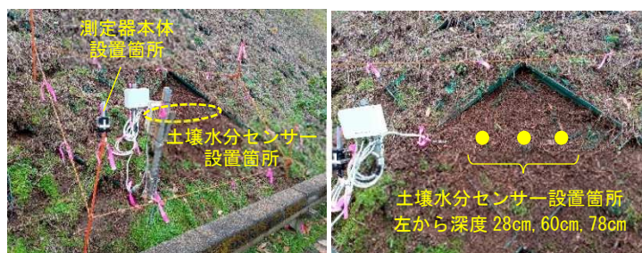
図-3 システム設置状況
