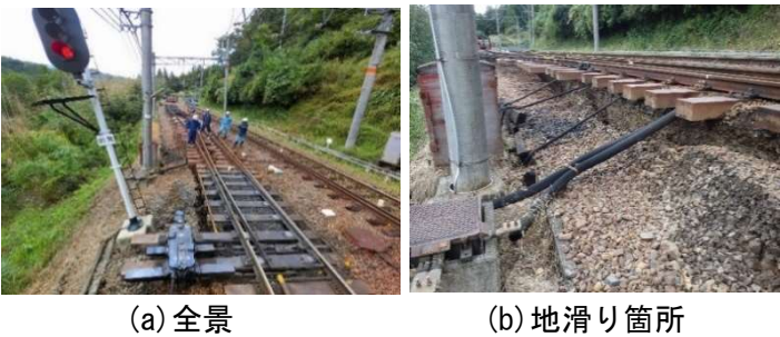
図-1 被災の状況
