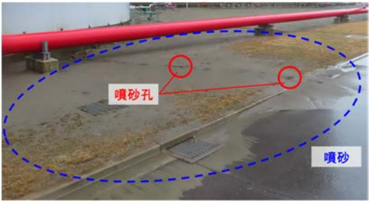
写真-1 被害事例（2021 年地震時）
