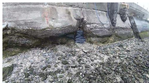
図-3 護岸の損傷箇所
