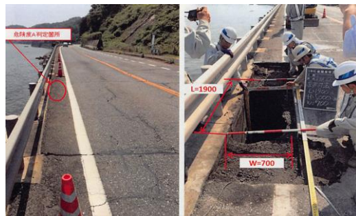
図-1 海岸護岸沿いの空洞例
