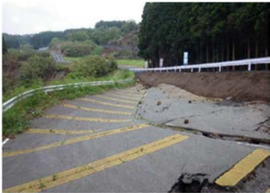
図-1 補強土擁壁の被害の様子
