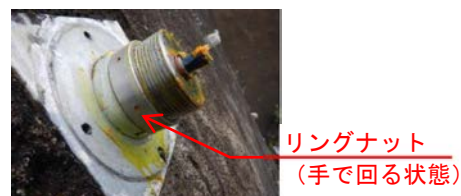
図-3 キャップを外した状態
