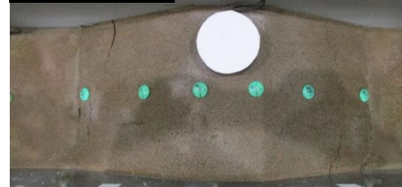
写真-5 加振後の堤体状況 (Case4)
