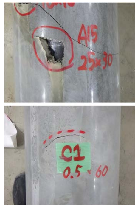
図-3 Case1 充填不良部
