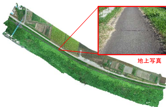
図-2 堤防天端舗装のひび割れの例
