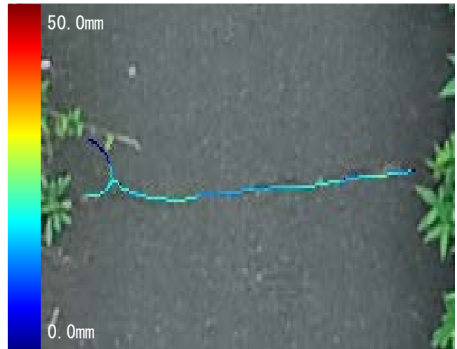
図-5 ひび割れ幅判定の例 (画像縦方向を2倍に引伸ばして表示)
