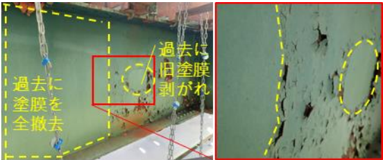
図-6 旧塗膜有無の劣化状況差
