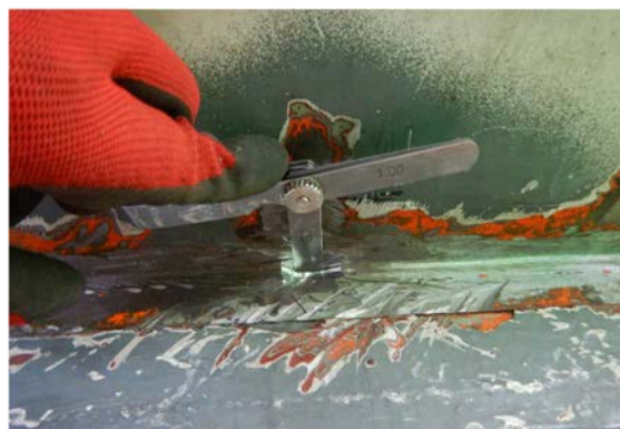
図3 き裂が生じている溶接部のルートギャップ
