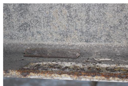
写真1 塗替え前のフランジ
