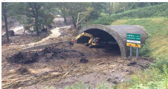
写真-1 台風10号による被災状況
