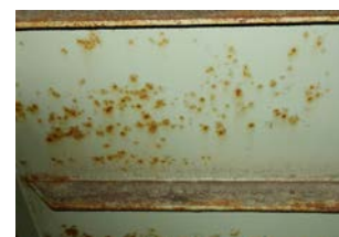
図-7 素地調整補助剤適用 箇所のさび（平面部）
