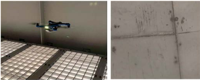
(a) 撮影状況 (b) 損傷撮影画像 図-6 ドローンによる撮影
