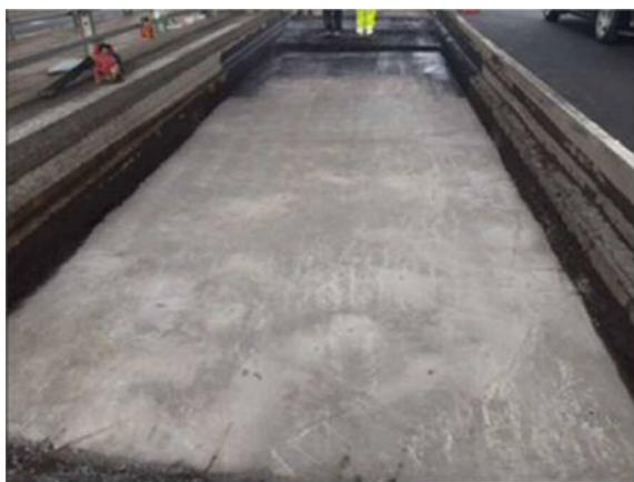
図-5 コンクリート版状況(29kp 付近)
