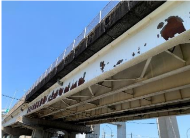
図1 塗膜剥離の例
