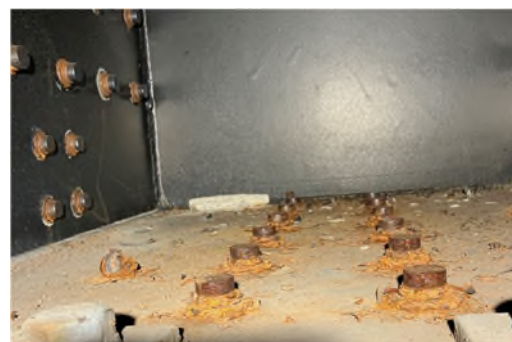
写真-2 バルブスリーブの腐食状況
