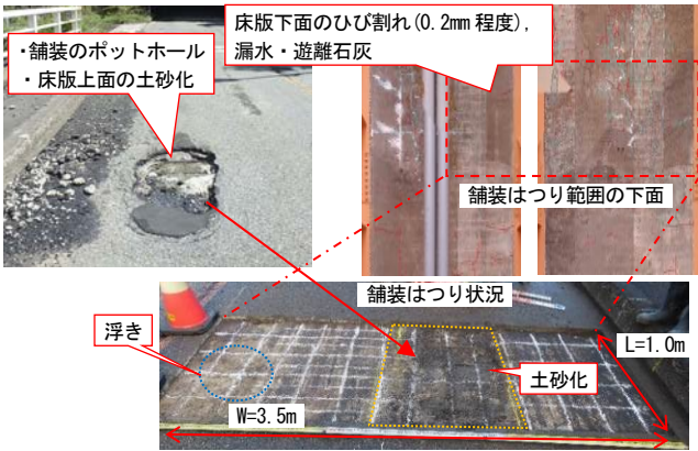
図-2 A 橋 床版の損傷状況（R3 年度）
