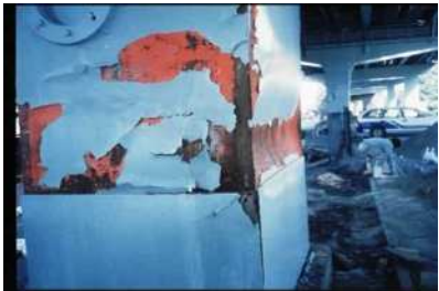
写真1 脚柱局部座屈事例
