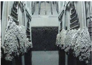
写真 1 クリンカ付着、堆積状況 1)
