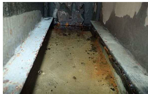
写真-4 鋼製高欄の内部滞水(損傷再発)
