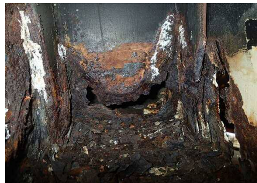
写真-3 鋼製高欄の内部腐食
