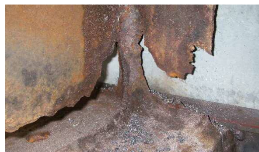
写真-5 内部のみ損傷進行(外面は健全)
