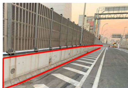
写真-1 鋼製高欄
