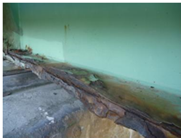
図-1.1 鋼橋のさび状況
