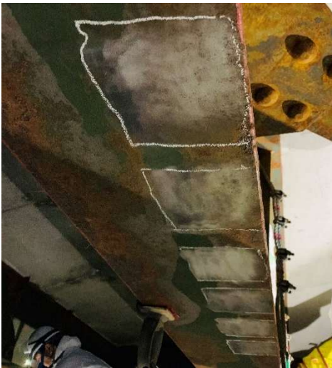
図 1 素地調整後の下フランジ下面
