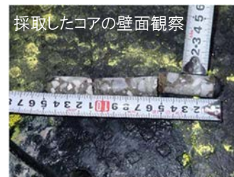
鉄筋位置でひびわれ
