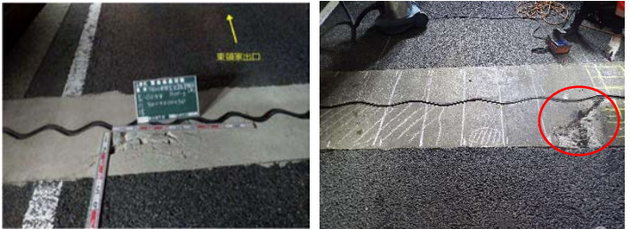
写真-1 後打ちコンクリート破損事例
