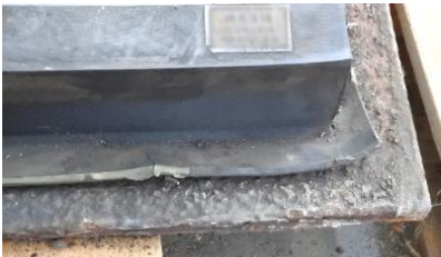
図-1 ゴムダンパーに発生した剥がれ
