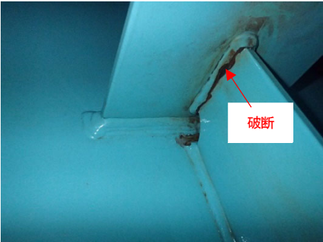
写真-3 垂直補剛材上端部のき裂 (NG3-S13)
