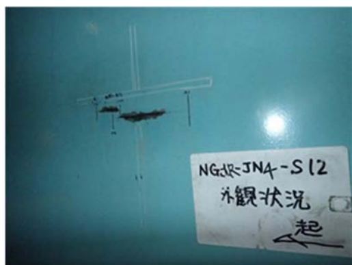
写真-1 拡幅 I 桁外面側き裂状況(NG3-S12)
