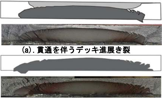
図2 デッキ貫通、進展き裂の一例
