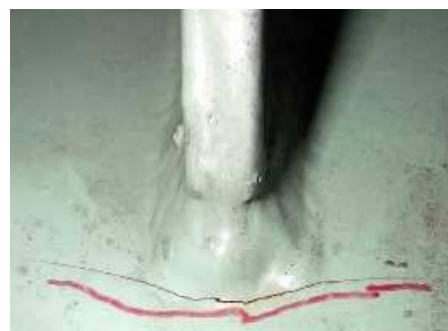
写真 1 き裂の発生状況図
