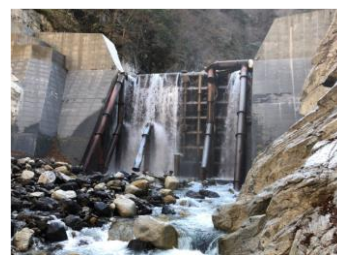
写真-1 被災景況
