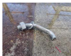
(b) Uボルトの破断
