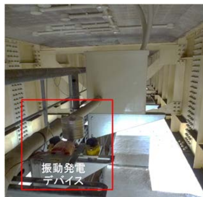
写真-1 磁歪式振動発電デバイスの設置状況
