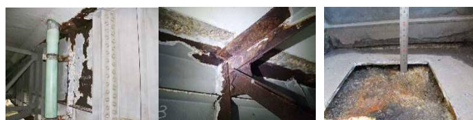
写真-4 損傷状況
