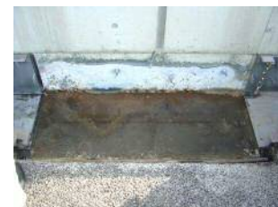
写真-2 底面下部の滞水
