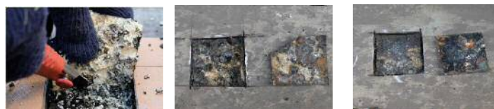
(1) 密に充填・厚み 25mm (2) 注入材と敷 Mo 混在 (3) 注入材確認できず
