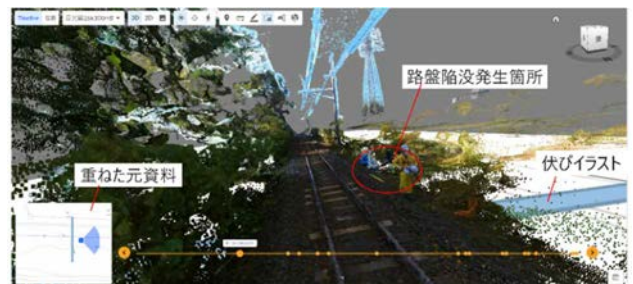
図2 路盤陥没現場の3D点群と伏び位置資料
