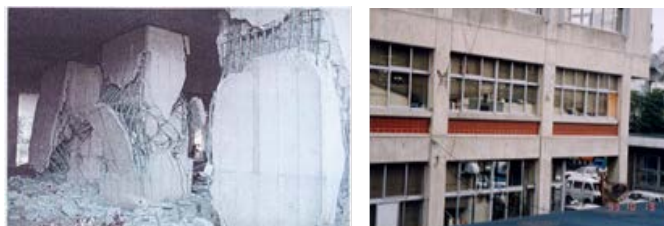
図-2 RC橋脚とビルの柱の共役せん断ひび割れ
