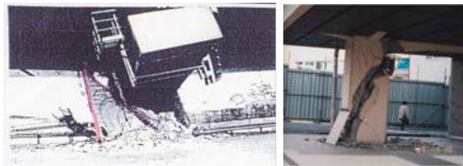
図-1 大小のRC柱のせん断破壊例
