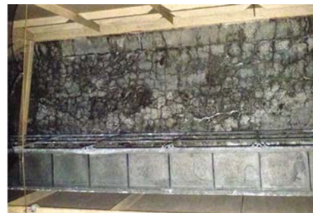
写真-1 床版下面の劣化状況
